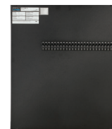
建筑调光和开关电柜 (GP, XP, LP)
